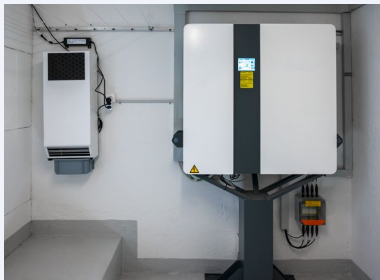
Già prima del risanamento l'edificio era riscaldato tramite teleriscaldamento.
